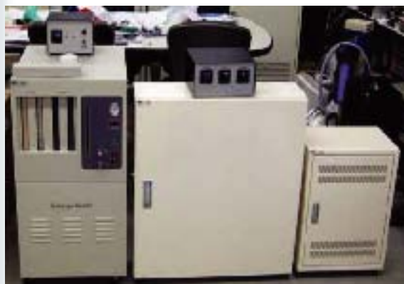
水素エネルギー貯蔵システム
