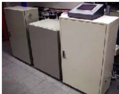
バイオマス水素発生発電システム
