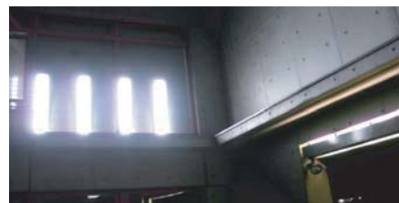
非常用照明電源の製作例
